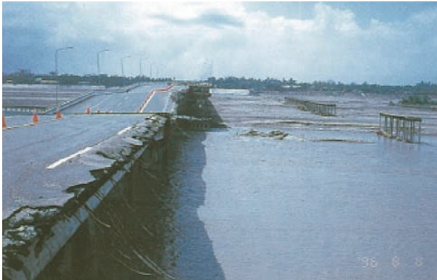
里港大橋舊橋沖失與橋面凹陷（一）
