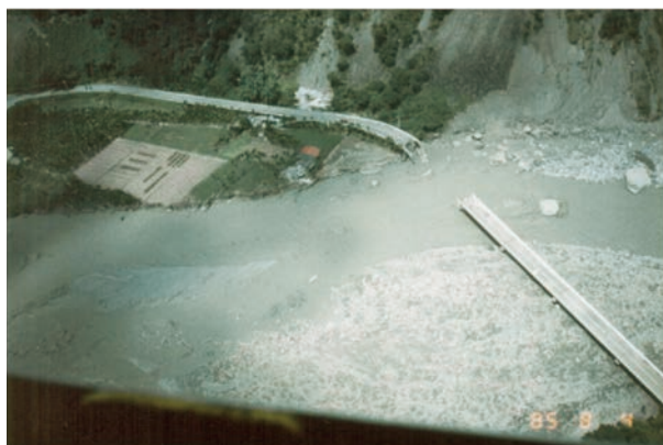
臺 21 線陳友蘭溪橋災損照片
