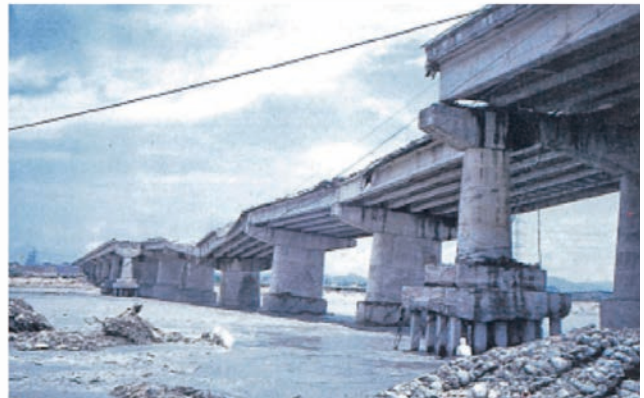
里港大橋舊橋沖失與橋面凹陷（二）
