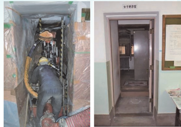
圖 6 大阪府中之島圖書館—狹隘空間且超低淨高之施工 (辻直樹等, 2016)
