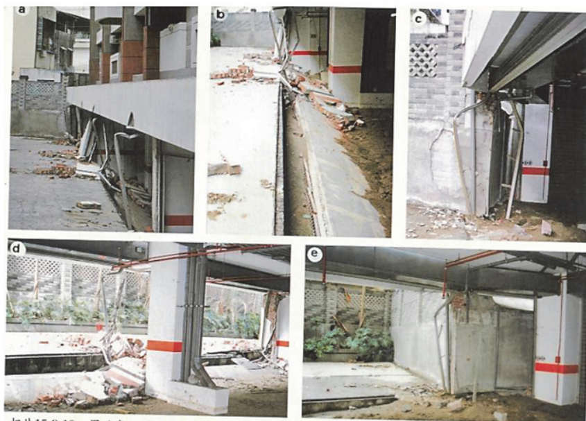
相片15-3-12 軍功寮加州陽光大樓土壤液化災況之細部畫面。(a)整棟大樓相對於車道路面已然(不均勻)下陷；(b)車道與車庫間之排水溝已被噴出砂土淤塞、且車庫邊緣底版傾斜抬升破裂；(c)相對於圖15-3-5右下角之災況；(d, e)車庫內可見大量之噴砂。摘錄自林呈(2000)
