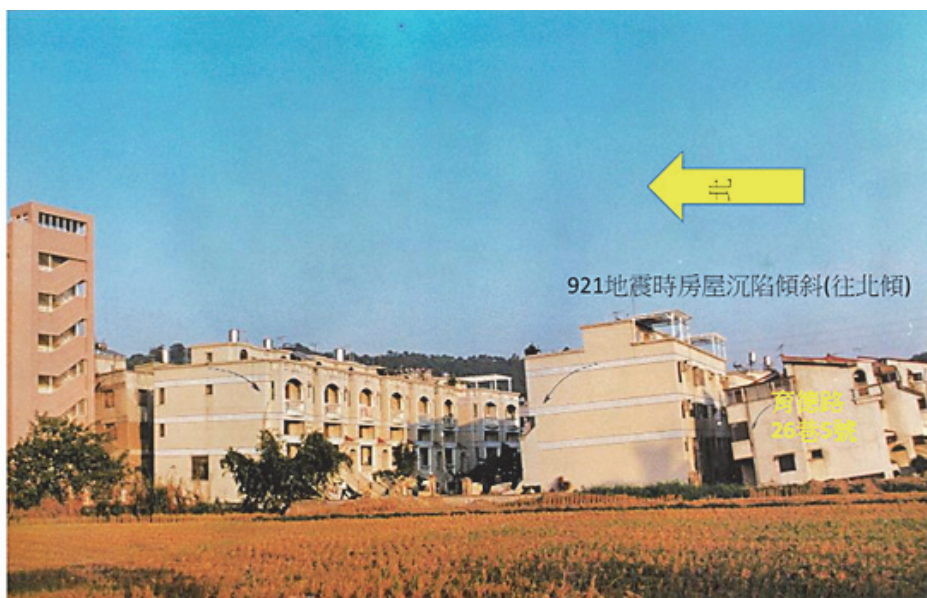
圖 7.2-16 霧峰育德路 26 巷 5 號建物向北沉陷傾倒情形
