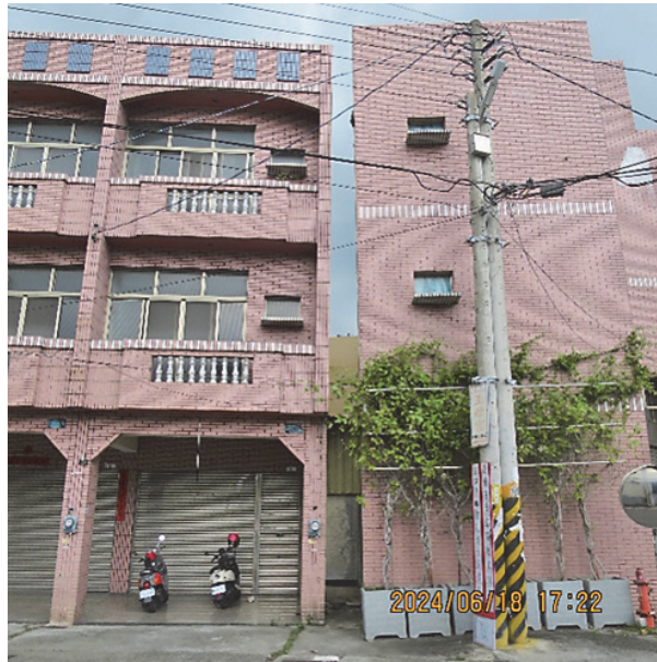
圖 7.2-18 員林崙雅巷連棟建物傾斜現況
