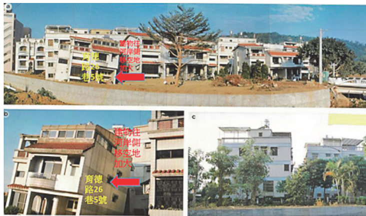
圖 7.2-15 霧峰育德路太子城堡社區 921 地震建物傾倒損壞情形
