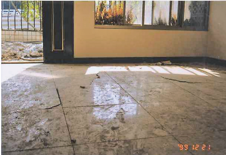
圖 7.1-4 灌漿施工時造成鄰房地坪隆起
