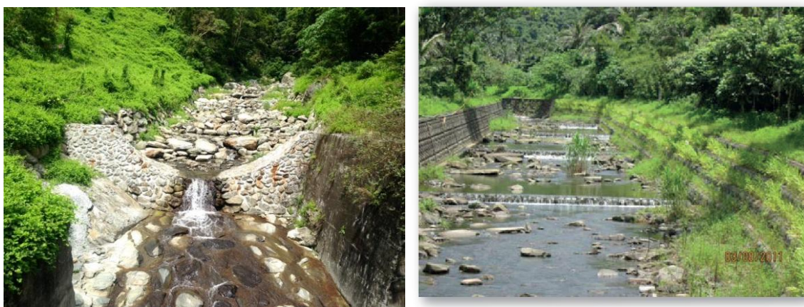
圖3-1-6 塊石混凝土壩及固床工 資料來源:農業部農村發展及水土保持署
