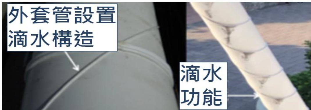
吊索外部 HDPE 套管設置滴水線(參考交通部特殊性橋梁研習資料)
